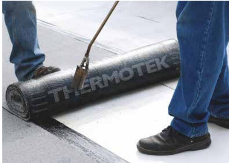
En los establecimientos comerciales, utilizan para la impermeabilización de los techos el poliuretano modificado y los mantos asfálticos
